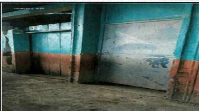
Foto 2: En esta fotografía se observa la puerta de madera que se necesita sustituirla a puerta de metal.
