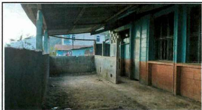
Foto 3: En esta fotografía se observa la necesidad de fundir en entornado del corredor de la escuela.
