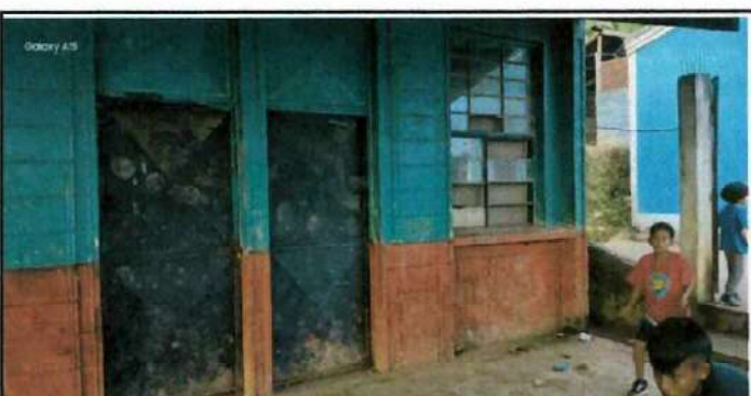
Foto 6: En esta fotografía se observa la necesidad de pintar las paredes y las ventanas de igual forma.
