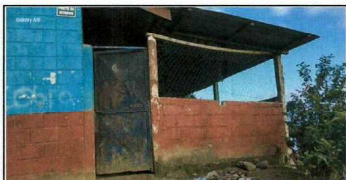
Foto 5: En esta imagen se puede apreciar la puerta principal en mal estado y que se necesita sustituirla a puerta de metal.
