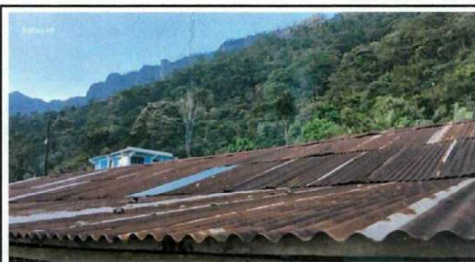
Foto 4: En esta fotografía de observa el entechado en total deterioro.
